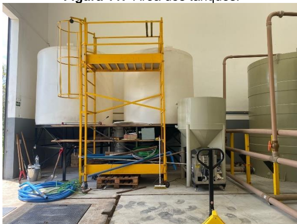
Figura 11: Área dos tanques.
