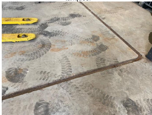
Figura 15: Canaletas de contenção na área dos tanques.
